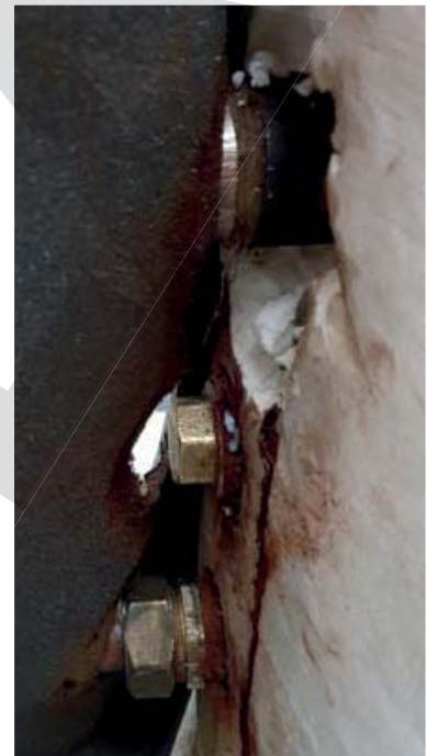
Rézcsővel „kötött” acéltartály csatlakozóinak elektrokémiai korróziója 16 hónap üzemeltetés után, a csatlakozók hegesztési varratainál már első üzeméven belül szivárgást okozhat.
