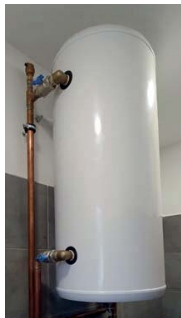
Rézcsővel csatlakoztatott melegvíztároló, hiányzik: tároló földelés és dielektromos közcsavar (plusz tágulási tartály).
